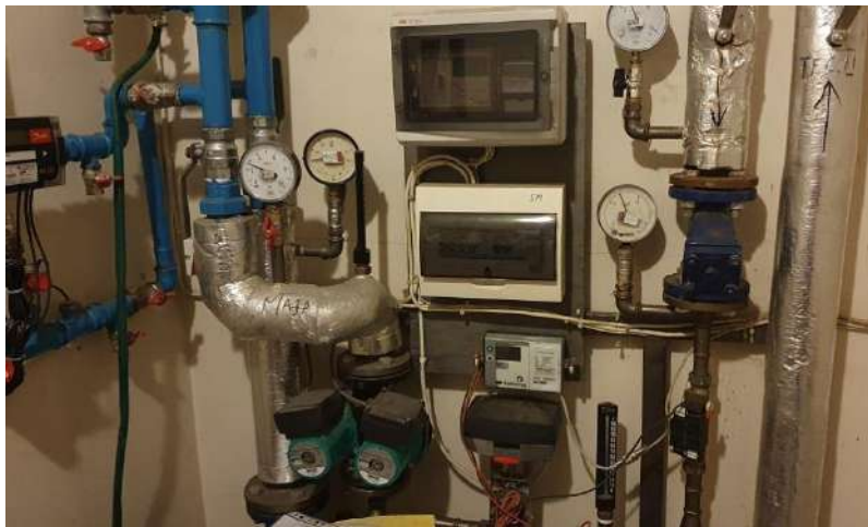
5.4.1.3.attēls. Siltummezgla automātika, siltuma skaitītājs, cirkulācijas sūkņi
