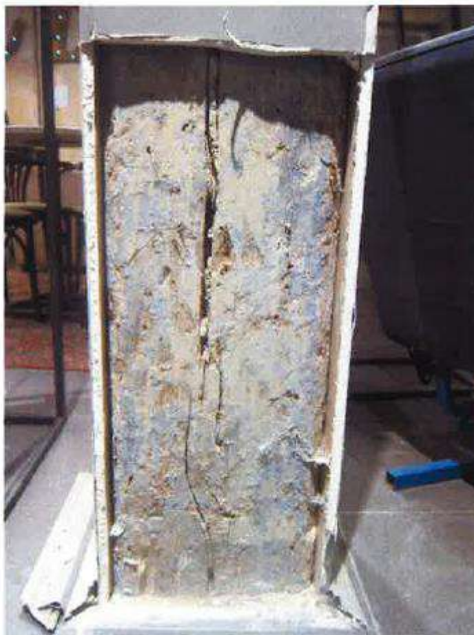
4.3.1.2. attēls. Koka kolonnas apšuvuma atsegums Attēls no A. Blumberga, LBS sert. Nr. 5-01475, 14.02.2018. apsekojuma
