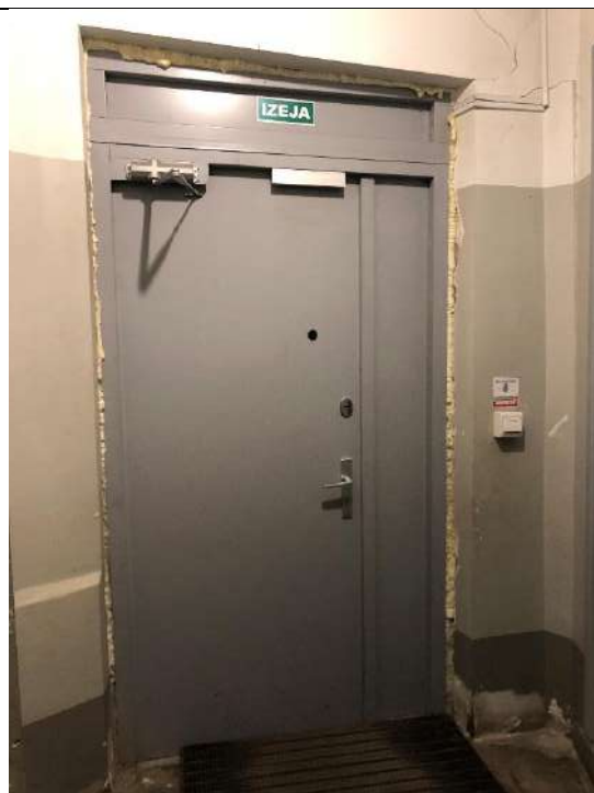
4.13.2.2. attēls. Metāla ārdrurvis – skats no iekštelpām
