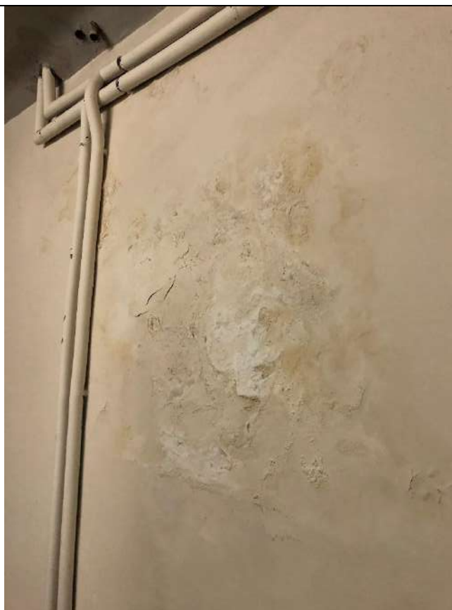
4.1.2.7. attēls. Mitruma radīts bojājums (telpa Nr. 12)
