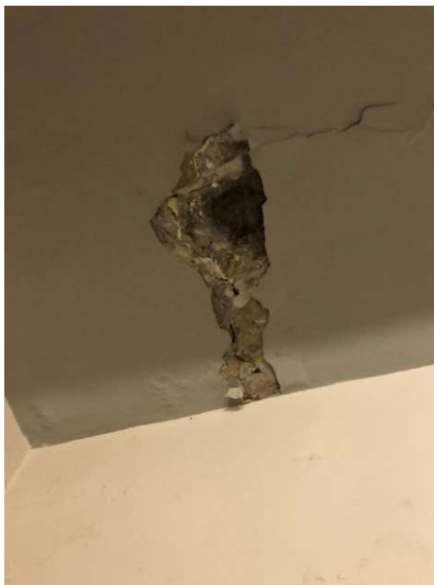
4.6.1.8 attēls. Ķieģeļu izdrupums pārseguma konstrukcijā,
