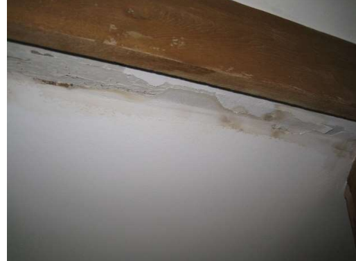
Telpas ēkas 4.stāvā, mitruma radīti bojājumi
