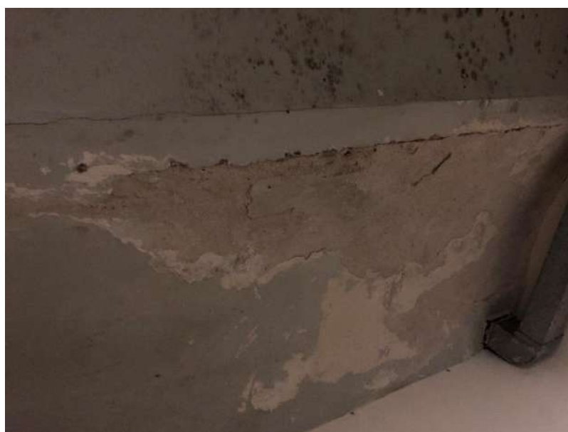
4.6.1.12 attēls. Mitruma piesātinājums – plaisas, metāla sijas korozija, apdares atslāņošanās
