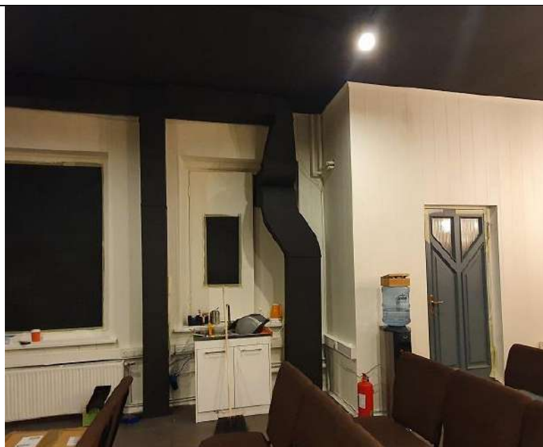
5.6.1.4.attēls. Nokrāsoti ventilācijas gaisa vadi 1.stāvā
