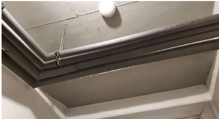
5.4.1.4.attēls. Izolēti apkures cauruļvadi pagrabā
