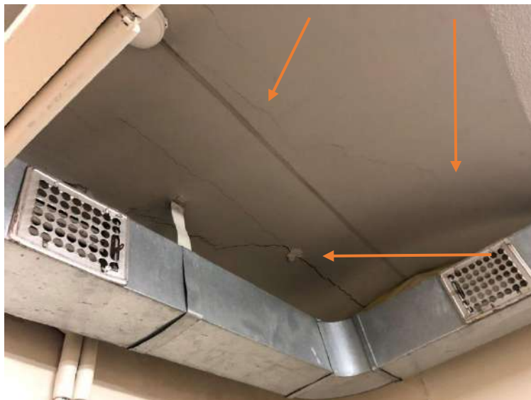
4.6.1.4. attēls. Plaisas pārseguma konstrukcijā, plaisai uzlikta kontrolmarka (bojājumu zona Nr. 1)
