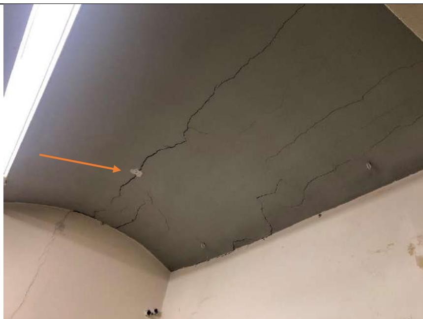
4.6.1.5 attēls. Plaisas pārseguma konstrukcijā, uzlikta kontrolmarka (bojājumu zona Nr. 1)
