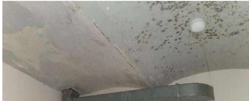
4.6.1.10 attēls. Mitruma piesātinājums, atslāņojies apmetums (bojājumu zona Nr. 3)
