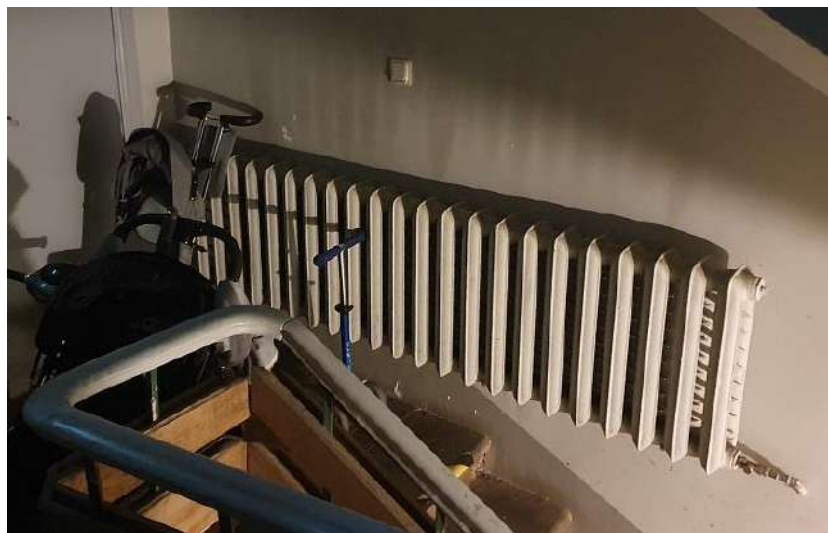
5.5.1.6.attēls. Čuguna radiators kāpņu telpā
