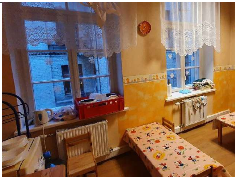
5.5.1.1.attēls. Tērauda radiatori ar termostātiem
