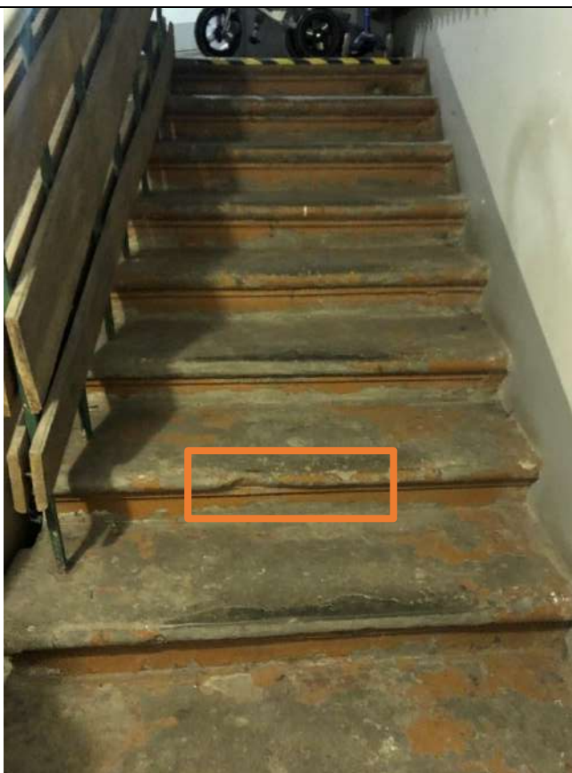
4.10.1.11. attēls. Kāpņu Nr. 3 pakāpienu bojājumi
