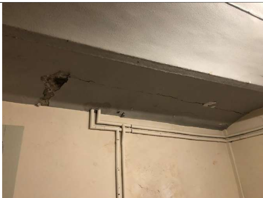
4.6.1.7 attēls. Plaisas un ķieģeļu izdrupums pārseguma konstrukcijā, uzlikta kontrolmarka (bojājumu zona Nr. 2)
