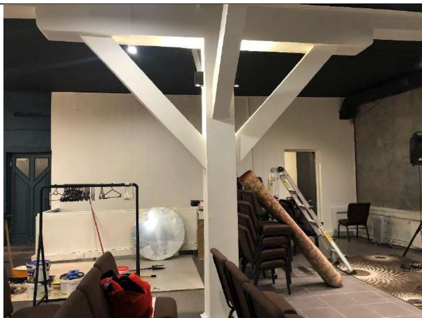
4.3.1.3. attēls. Kolonnas (att. Nr. 4.3.1.1.) apšuvums apsekošanas brīdī
