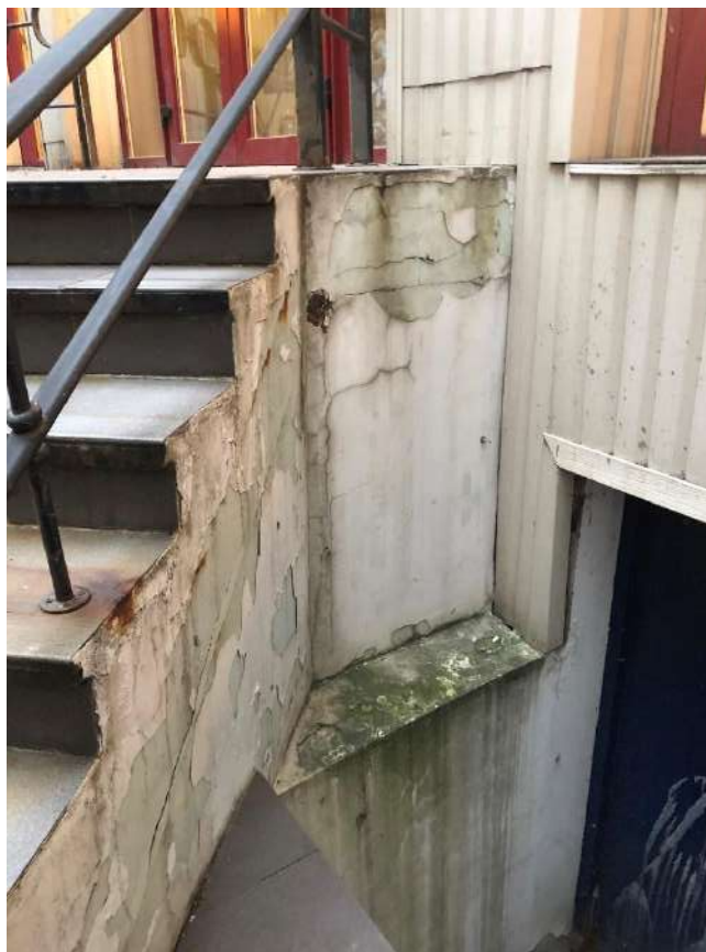
4.10.1.6. attēls. Kāpņu apdares bojājums
